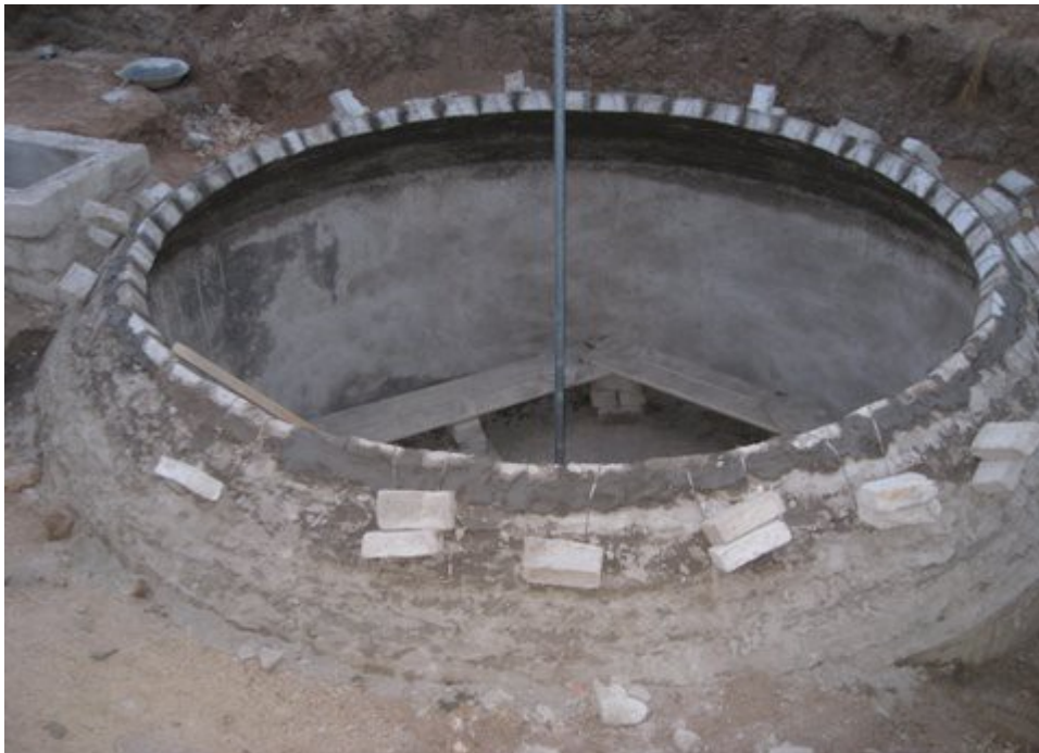
Illustrasjon 3: The biogas digester build from concrete bricks
